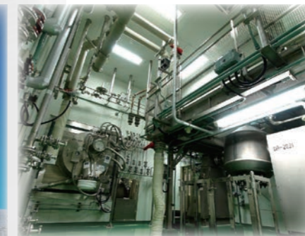
ケミカルハザード対応設備
