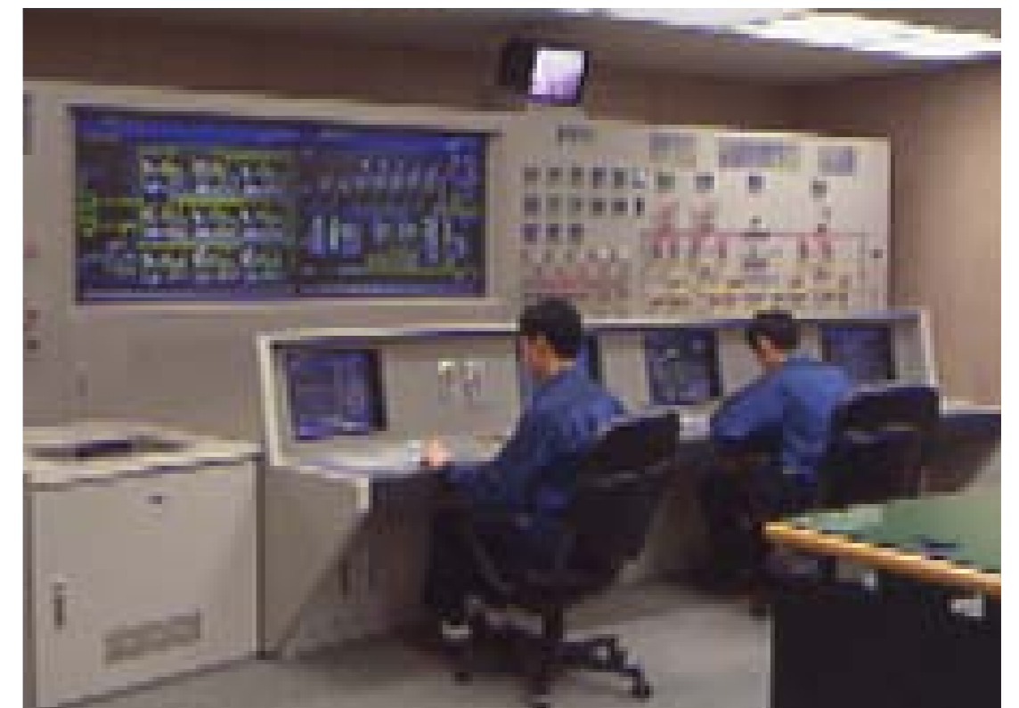
LNG設備中央操作室
