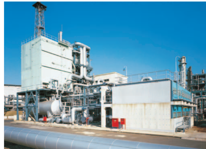
冷熱発電施設
