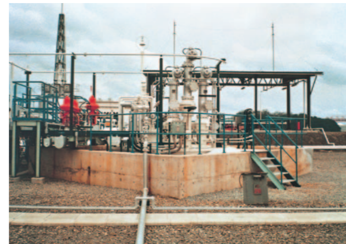
石油公団 水封式LPG地下岩盤備蓄技術実証プラント
