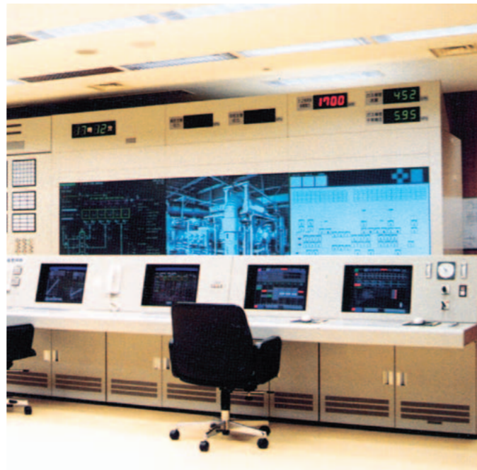
LNG シミュレータ設備全景
