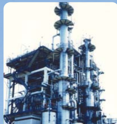
東亜石油(株)川崎 軽油深度脱硫装置
