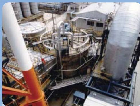
三菱油化(株)四日市 CT-121排煙脱硫装置商業1号機
