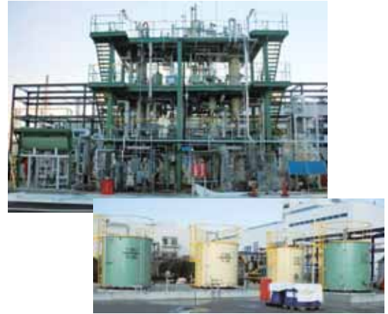
水素を固定・発生する反応のセクション部分(上)と貯蔵設備(下)
