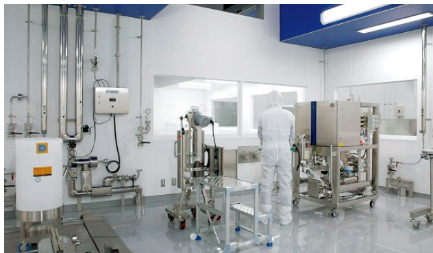
精製室（静岡工場「バイオプロセス開発棟建設工事」） （写真提供：シミックJSRバイオロジクス（株）／シミックCMO（株））
