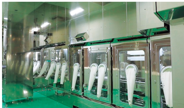
アイソレーター（足利工場「新注射剤棟建設工事」） （写真提供：シミックCMO株式会社）
