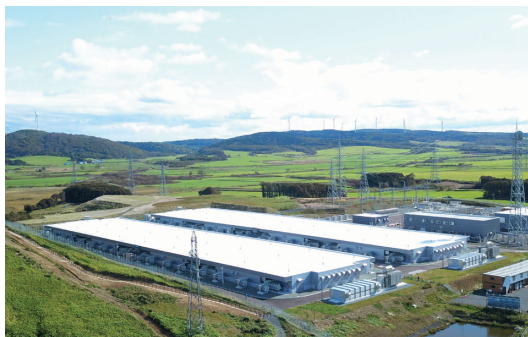
北豊富変電所蓄電池システム
