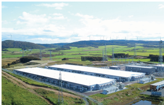
北豊富変電所蓄電池システム
