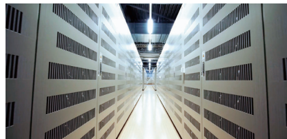
蓄電池システム内観 (提供：北海道北部風力送電株式会社)
