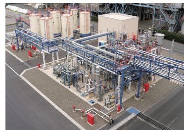
川崎における脱水素プラント（提供：AHEAD）
