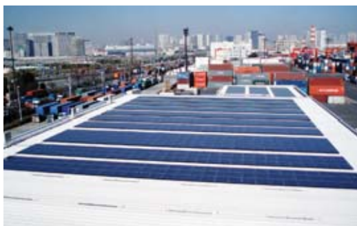
(株)商船三井/国際コンテナターミナル(株)向け 200kW 太陽光発電設備
