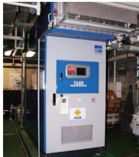
横浜本店のガスコージェネレーション設備
