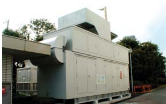
バイオ燃料コージェネレーション設備
