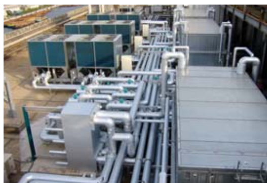
氷蓄熱空調設備
