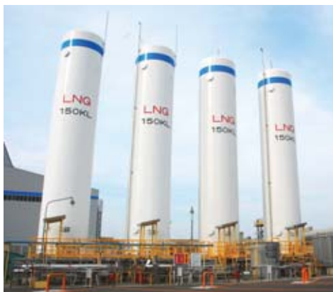
古河スカイ(株)向け LNG サテライト基地
