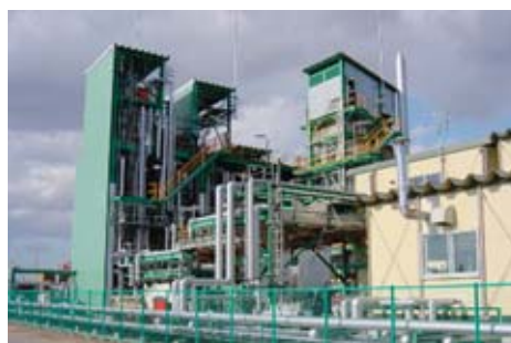
勇払GTLパイロットプラント
