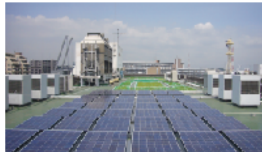
太陽光発電設備
