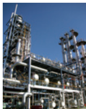
JX日鉱日石エネルギー(株)のHS-FCCプラント (写真提供:JX日鉱日石エネルギー(株))
