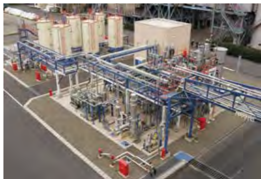
川崎臨海部の脱水素プラント
