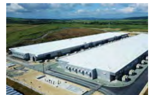
北海道北部風力送電(株)向け蓄電池システム建設現場(2020年7月撮影)
