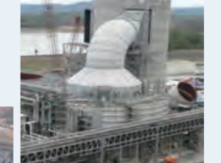
ジョージアパワー社(米国) ボーエン発電所CT-121排煙脱硫装置
