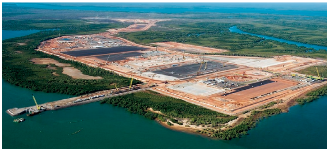
建設の始まったイクスプロジェクトの陸上LNG設備（オーストラリア連邦北部準州ダーウィン、ブレイディンポイント）
