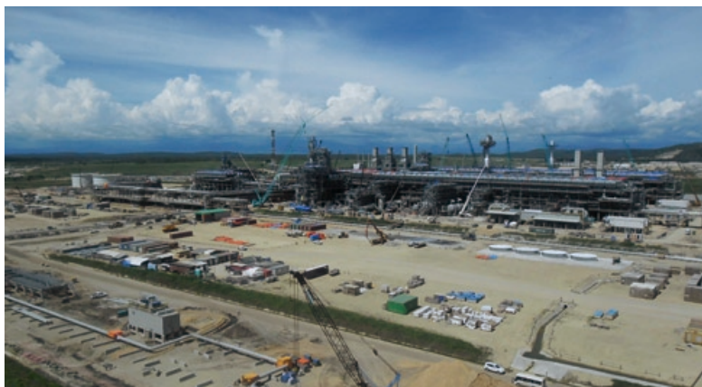
パプアニューギニアのLNGプラント 写真提供：エクソンモービル社
