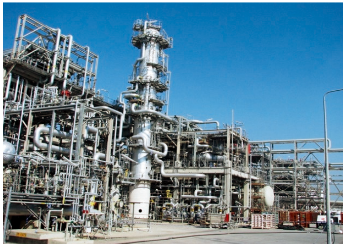
カタールのパールGTL（Gas to Liquids）プロジェクトのガス前処理プラント 写真提供：シェル社
