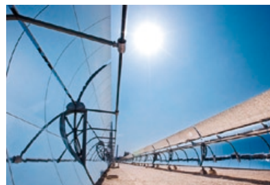
パイロットプラント集光設備（イタリア・シシリ島） (写真提供：ASE社、エネル社)
