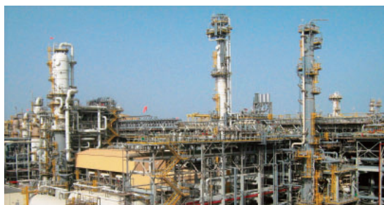
完成したLNGプラント第6系列（南西方面より） © RasGas Company Limited-2009
