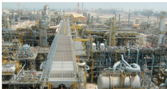
完成したLNGプラント第6系列（最上部） © RasGas Company Limited-2009
