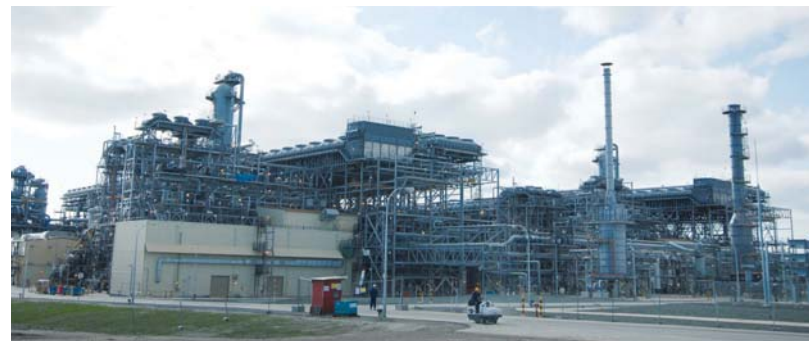
引渡しを完了したサハリンのLNGプラント
