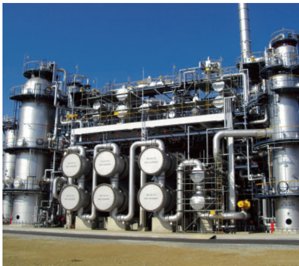
新日本石油精製(株)水島製油所向け第1 溶剤脱漉装置
