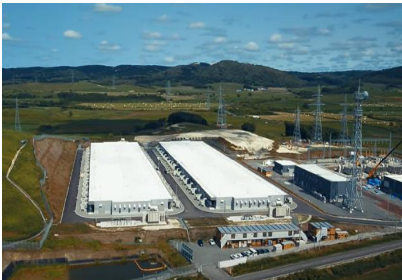
*1 蓄電池システム外観(全景)
