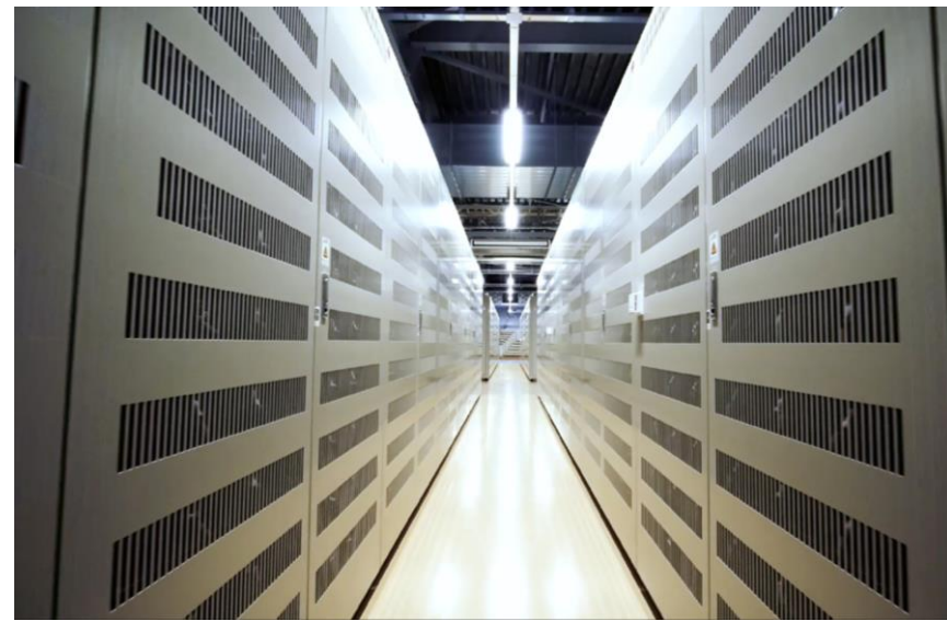
*1 蓄電池システム内観
