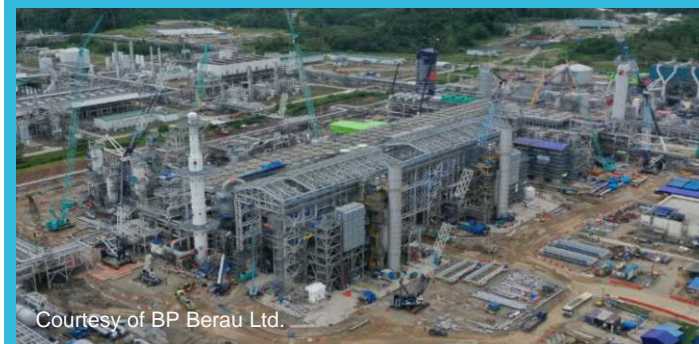
タンゲーLNG
