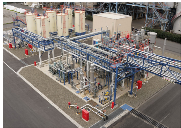
川崎脱水素プラント
