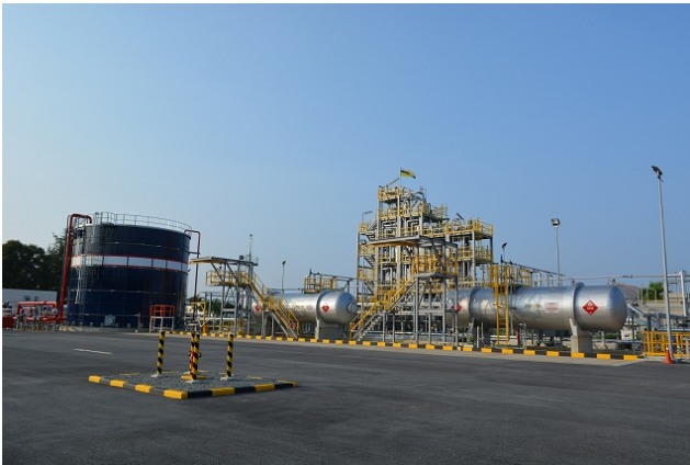
ブルネイ水素製造および水素化プラント
